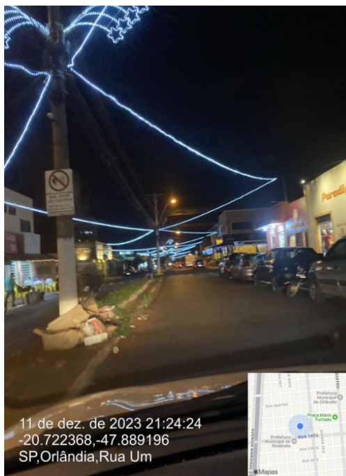
38 – Arabesco e mangueira apagados no trecho da Rua 1 (Item 25)
