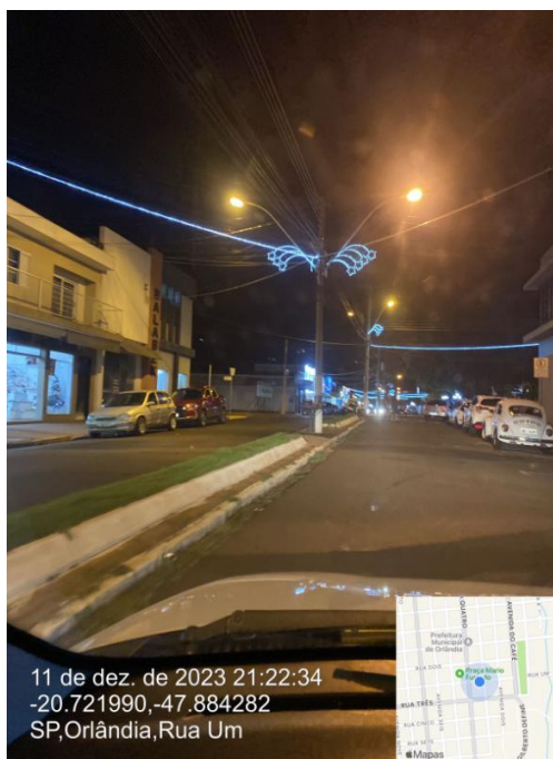
29 – Arabesco e mangueira apagados no trecho da Rua 01 (Item 25)
