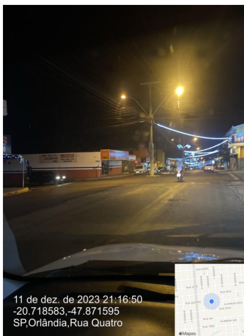
21 – Trecho de mangueira apagado no trecho da Rua 04 (Item 28)
