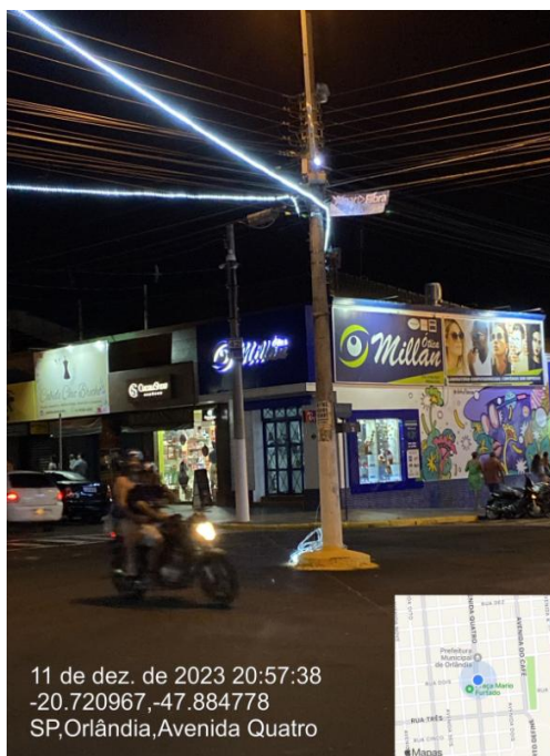
11 – Mangueira caída no cruzamento da Rua 02 com Avenida 04 (Item 26)
