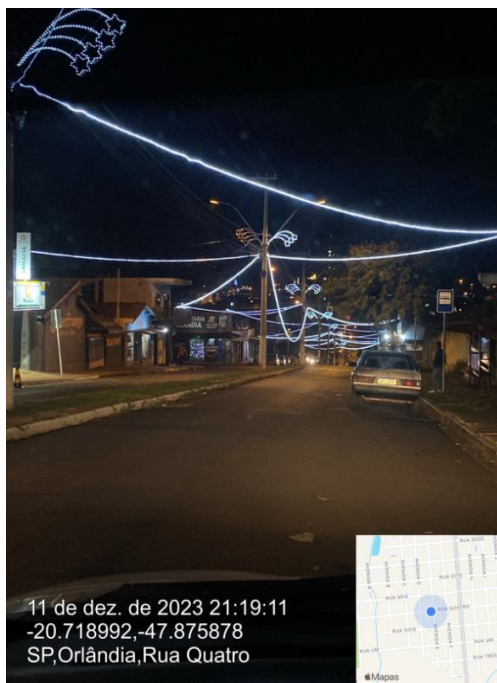
26 – Arabesco apagado e mangueira caída no trecho da Rua 04 (Item 28)
