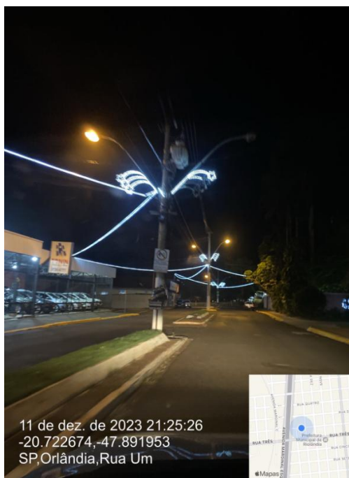
47 – Arabesco e mangueira apagados no trecho da Rua 1 (Item 25)
