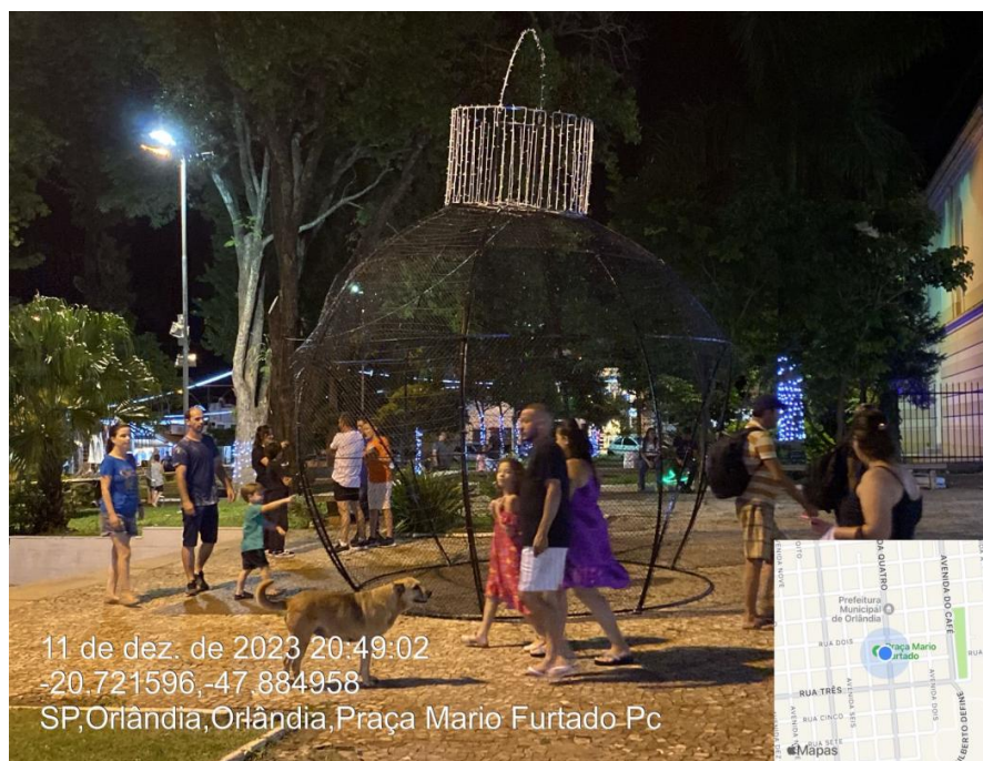
4 – Bola Luminosa apagada (Item 07)
