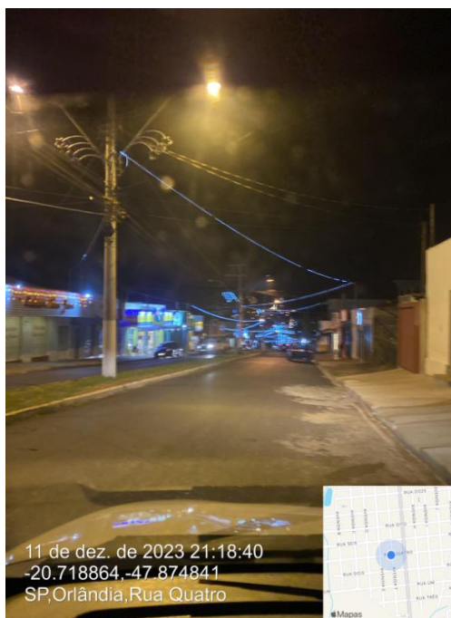
27 – Arabesco e mangueira apagados no trecho da Rua 04 (Item 28)
