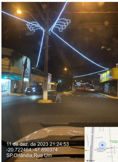
42 – Mangueira apagada no trecho da Rua 1 (Item 25)
