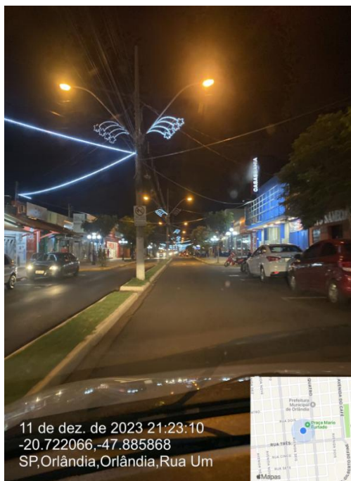
36 – Arabesco e mangueira apagados no trecho da Rua 1 (Item 25)
