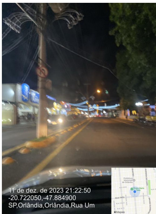
33 – Arabesco e mangueira apagados no trecho da Rua 1 (Item 25)
