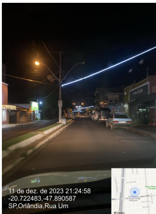
45 – Arabesco e mangueira apagados no trecho da Rua 1 (Item 25)
