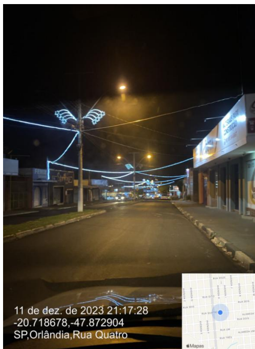
22 – Trecho de mangueira apagado no trecho da Rua 04 (Item 28)
