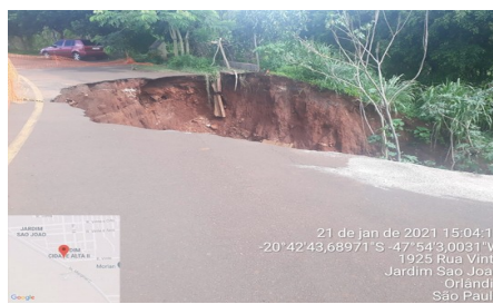
FOTO 2 - RUA 20, PONTO ATINGIDO PELA EROSÃO
