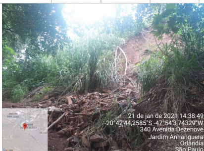
FOTO 5 - MARGINAL FEPASA, VISTA DA EROSÃO
