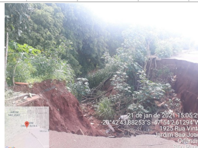
FOTO 4 - RUA 20, LOCAL ATINGIDO PELA EROSÃO (VISTA DE CIMA)
