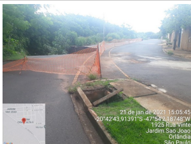
FOTO 1 - RUA 20, PONTO ATINGIDO PELA EROSÃO
