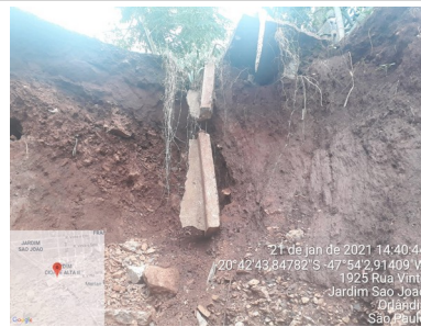
FOTO 6 - MARGINAL FEPASA, VISTA DA EROSÃO
