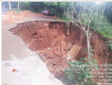
FOTO 3 - RUA 20, LOCAL ATINGIDO PELA EROSÃO (VISTA DE CIMA)
