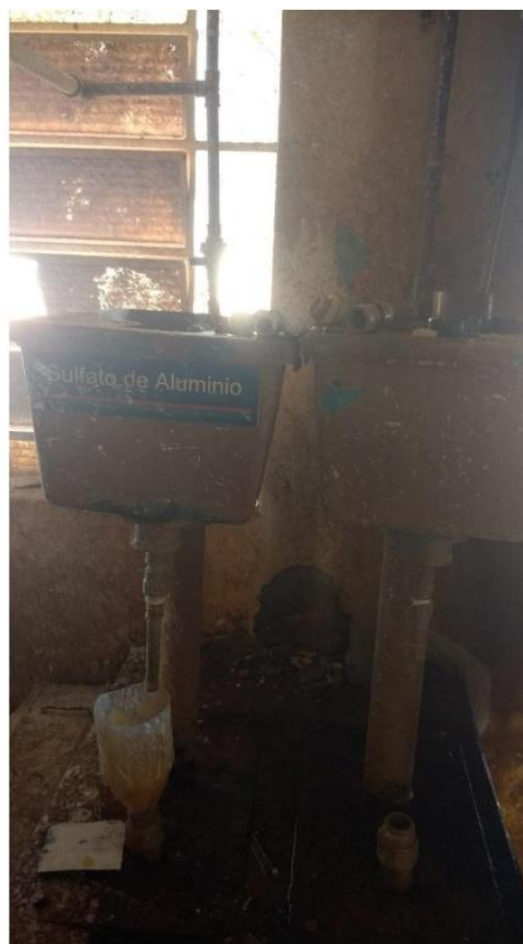
Figura 20 - Bomba dosadora de coagulante
