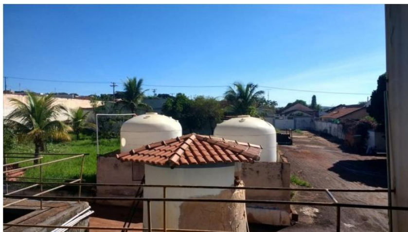
Figura 19 - Tanques de armazenamento de sulfato de alumínio
