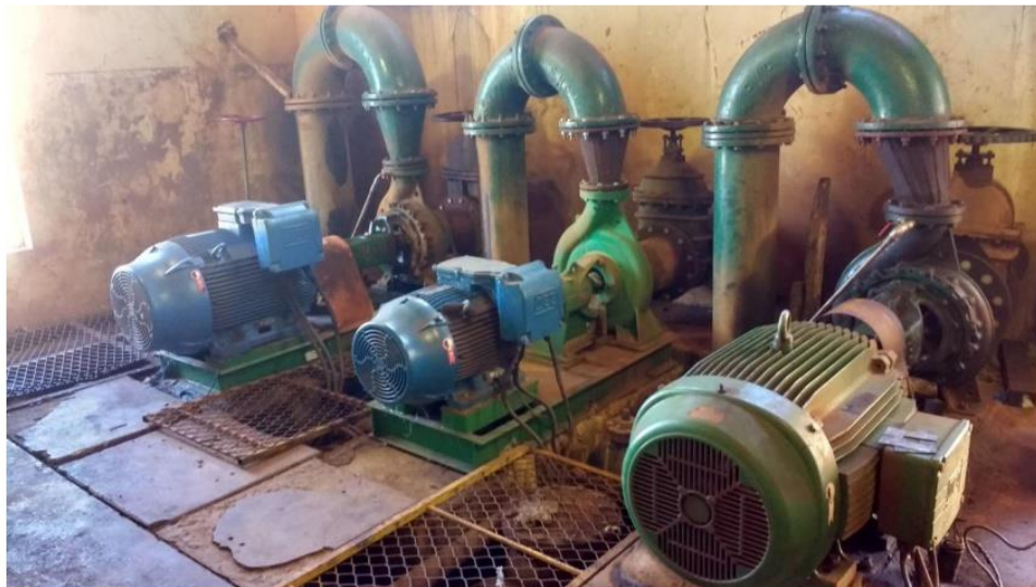
Figura 41 - Conjuntos Motobomba EEAB
