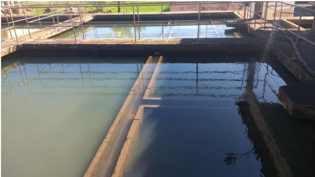
Figura 28 - Decantadores em operação afogados
