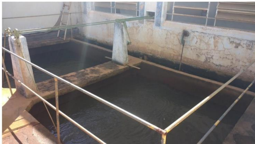
Figura 29 - Vista Geral de dois módulos de filtração
