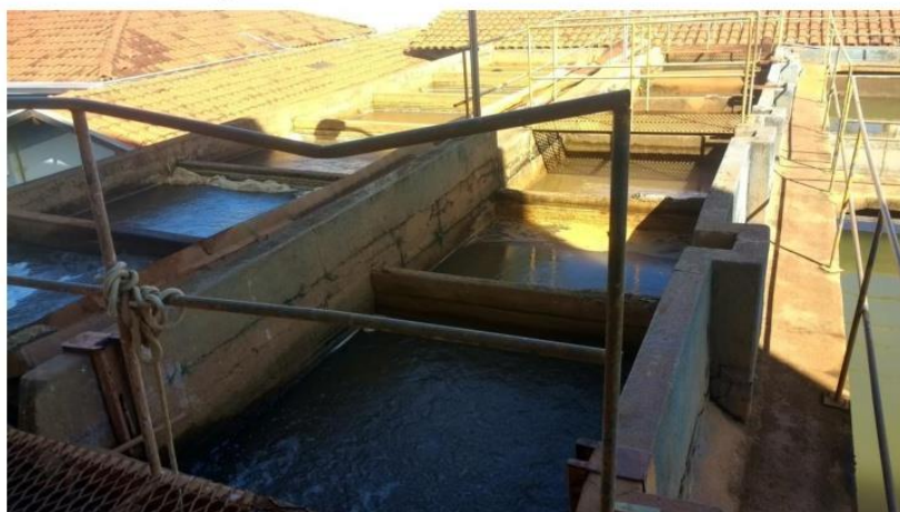
Figura 25 – Flocculadores da ETA de Orlandia
