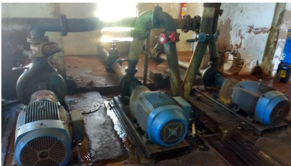
Figura 42 - Conjuntos Motobomba EEAT1
