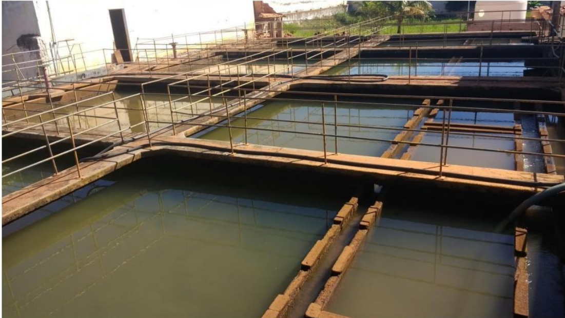
Figura 27 - Vista Geral dos decantadores, sendo duas unidades operando afogadas
