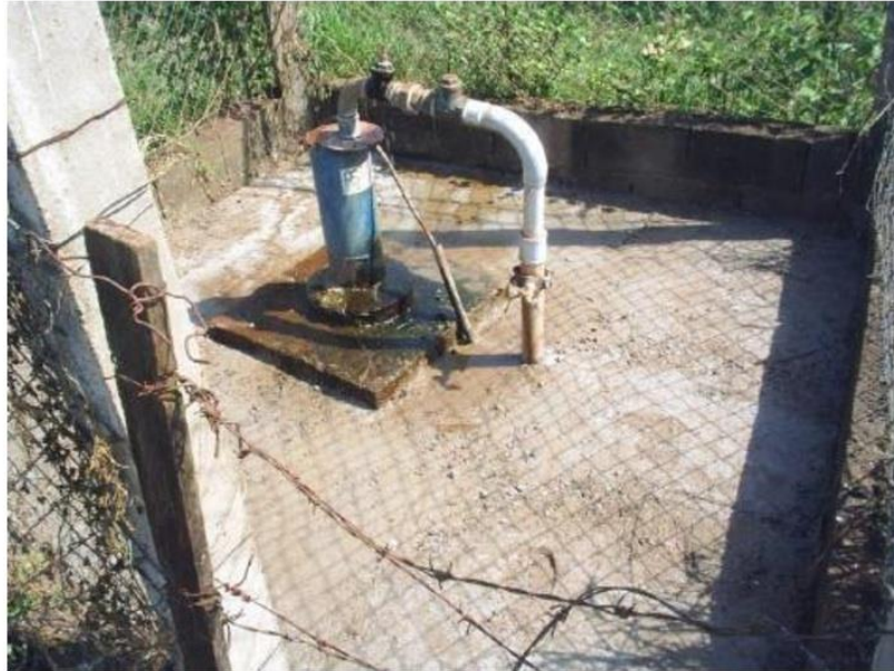
Figura 38 - Poço P10 - Capão do Meio
