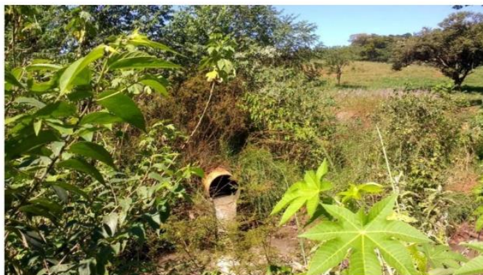
Figura 55 – Travessia Rompida no Ribeirão dos Agudos
