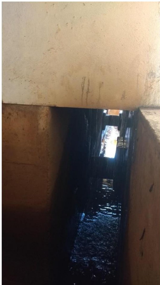
Figura 26 - Vazamento de grande proporção - ETA Orândia
