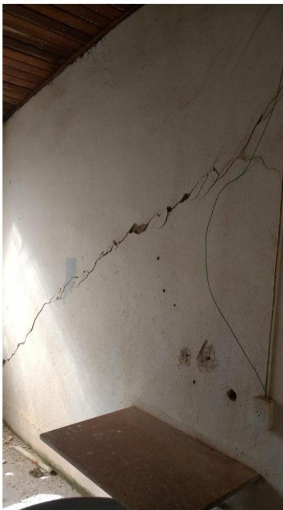
Figura 30 - Rachadura em parede do edifício da ETA
