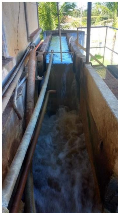
Figura 24 - Dispositivo de mistura rápida - ETA
