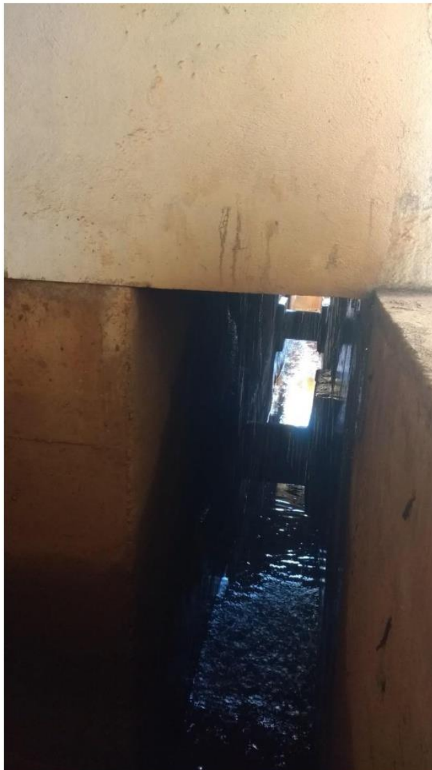
Figura 26 – Vazamento de grande proporção – ETA Orlandia
