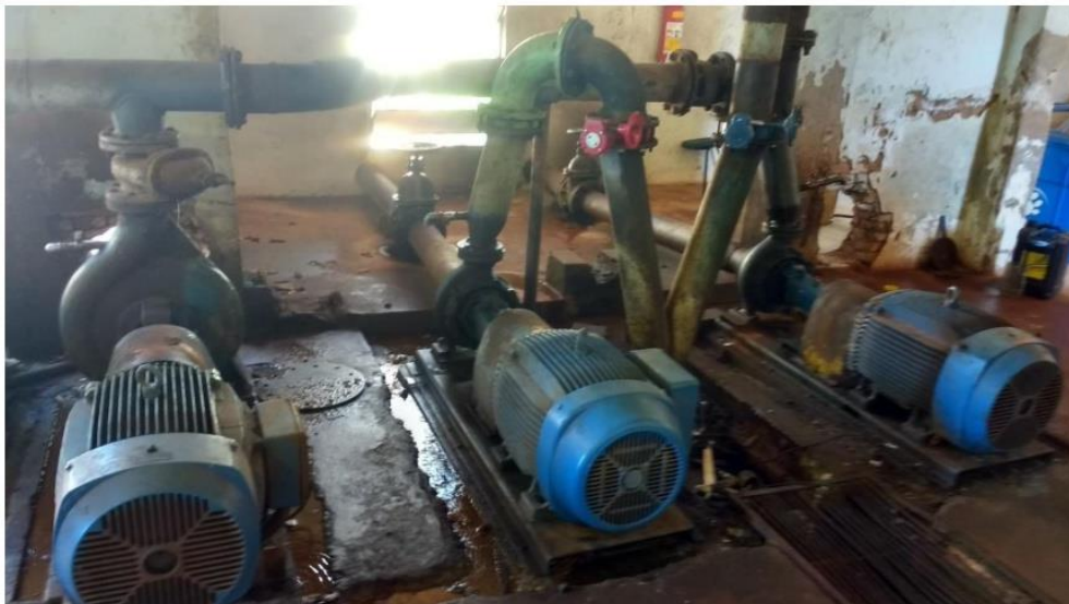
Figura 42 – Conjuntos Motobomba EEAT1
