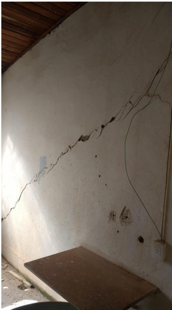
Figura 30 – Rachadura em parede do edifício da ETA
