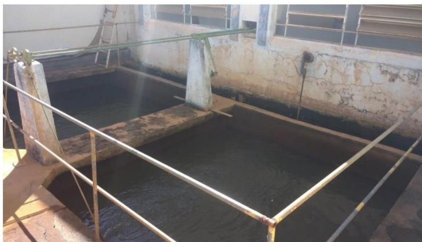
Figura 29 – Vista Geral de dois módulos de filtração
