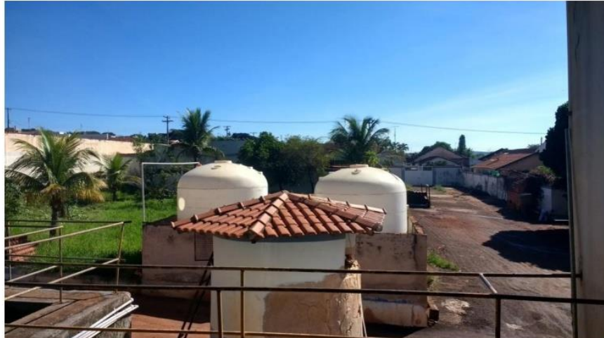
Figura 19 – Tanques de armazenamento de sulfato de alumínio
