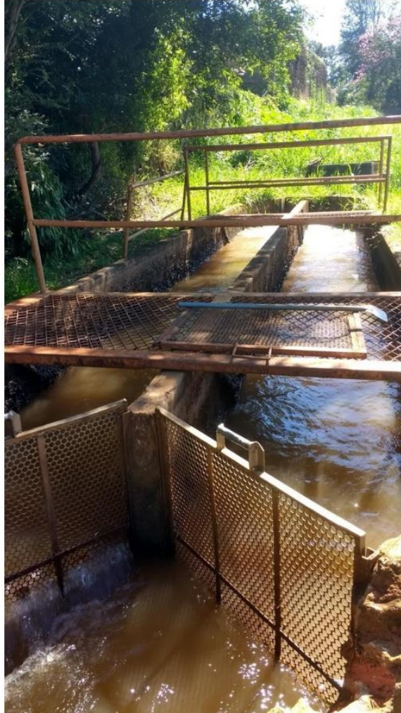
Figura 11 – Gradeamento e canal desarenador captação de água bruta
