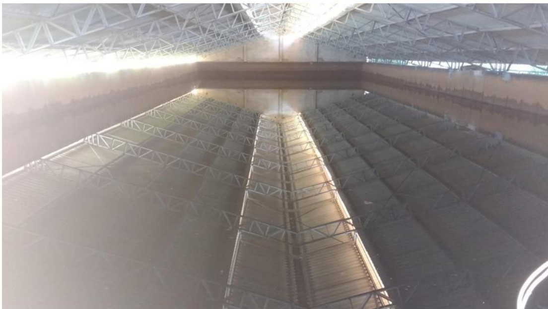
Figura 39 – Reservatório R5 – CR ETA
