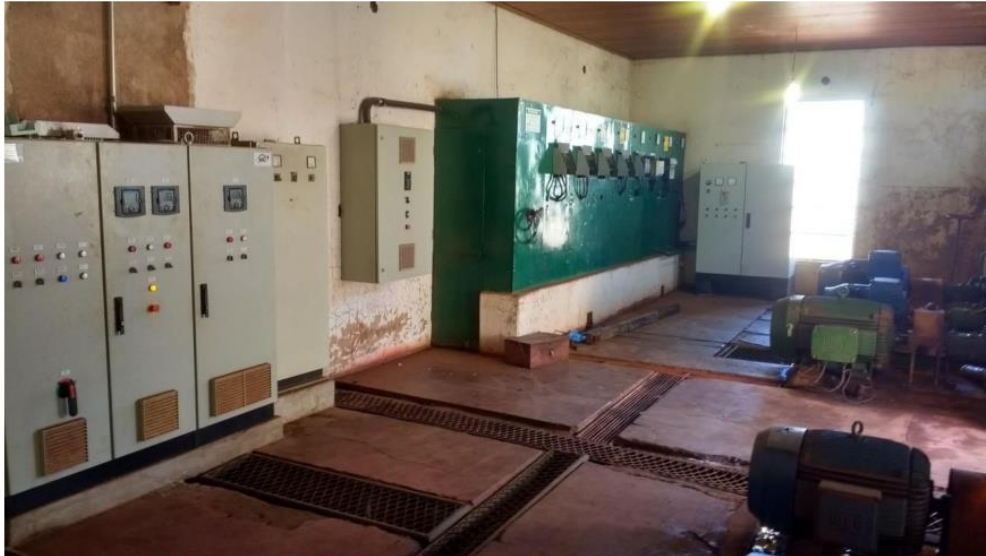
Figura 44 – EEAB e EEAT1
