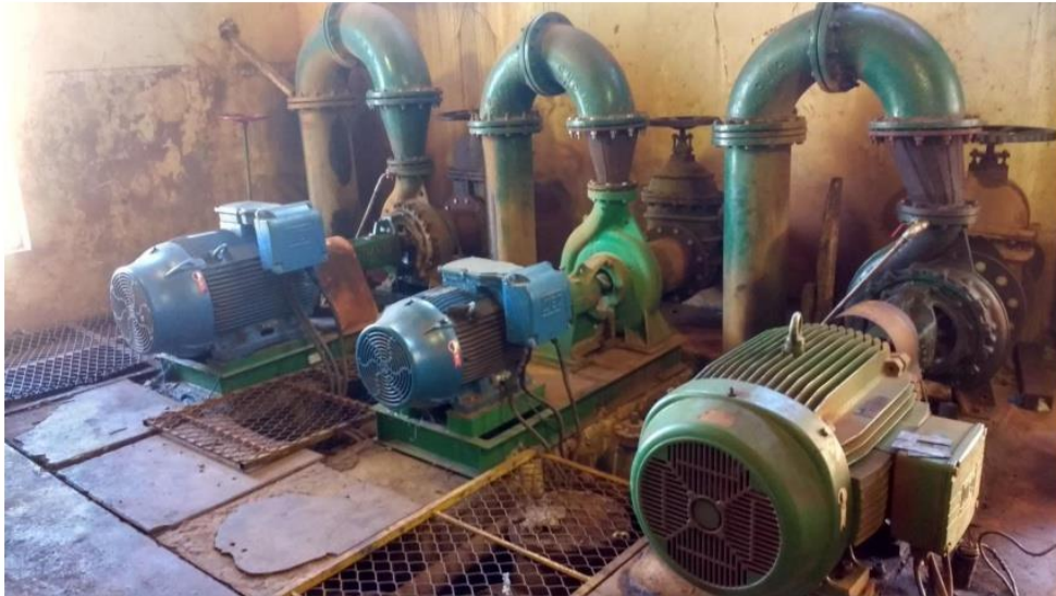
Figura 41 – Conjuntos Motobomba EEAB
