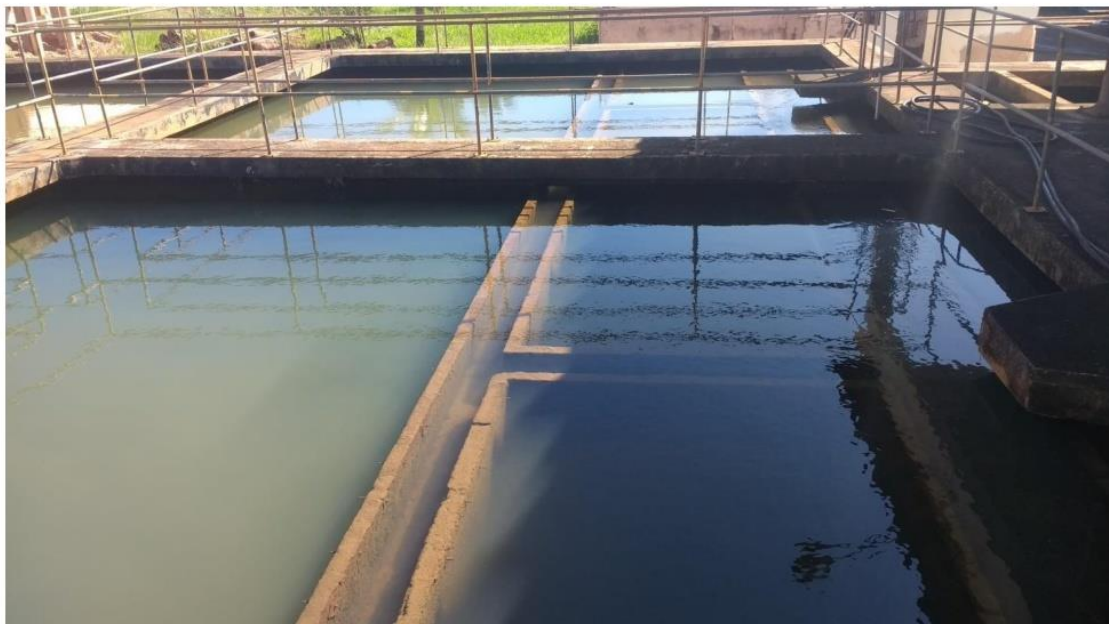
Figura 28 – Decantadores em operação afogados
