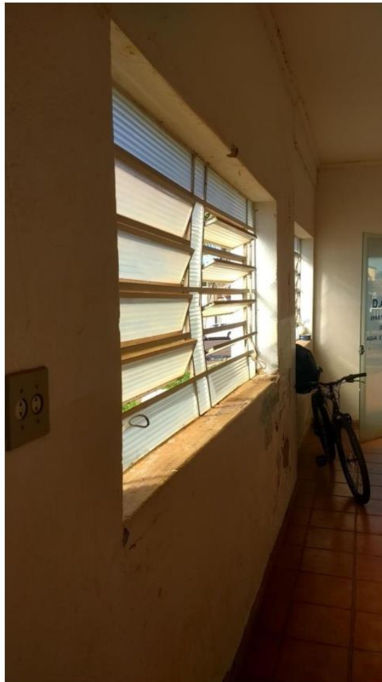
Figura 33 – Deflexão em caixilho caracterizando o recalque estrutural no edifício da ETA
