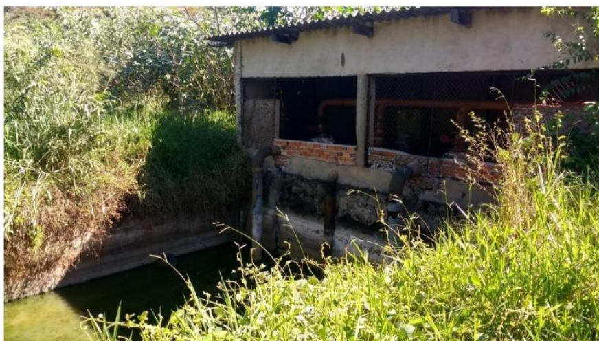
Figura 57 – Poço de Sucção da Estação Elevatória de Esgotos de Orlandia
