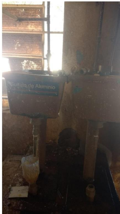
Figura 20 – Bomba dosadora de coagulante
