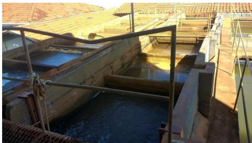
Figura 25 – Floculadores da ETA de Orlandia
