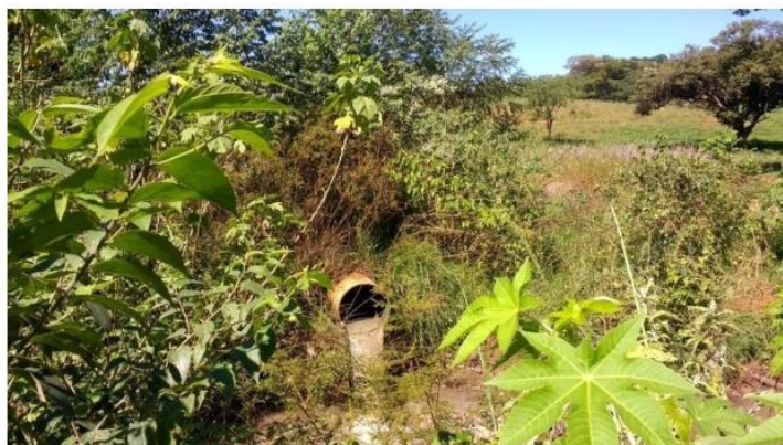
Figura 55 – Travessia Rompida no Ribeirão dos Agudos
