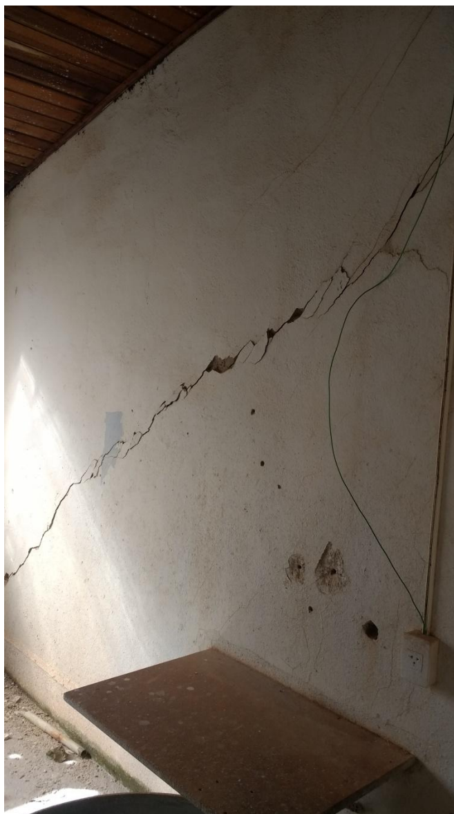
Figura 30 – Rachadura em parede do edifício da ETA
