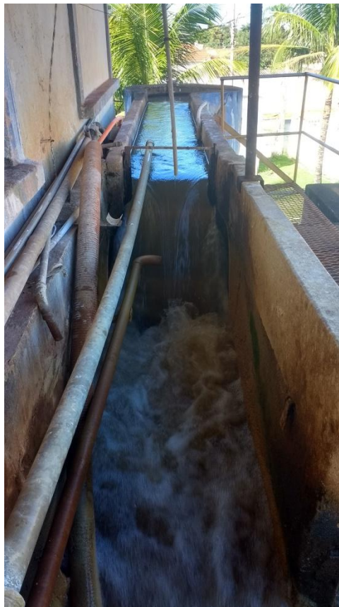
Figura 24 – Dispositivo de mistura rápida - ETA
