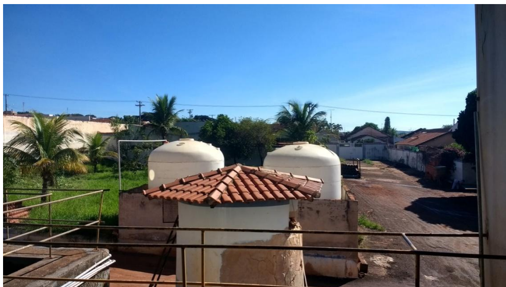
Figura 19 – Tanques de armazenamento de sulfato de alumínio
