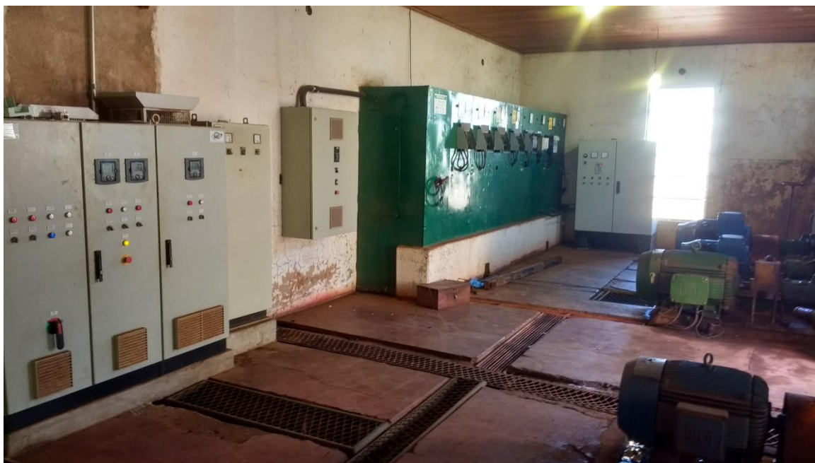
Figura 44 – EEAB e EEAT1
