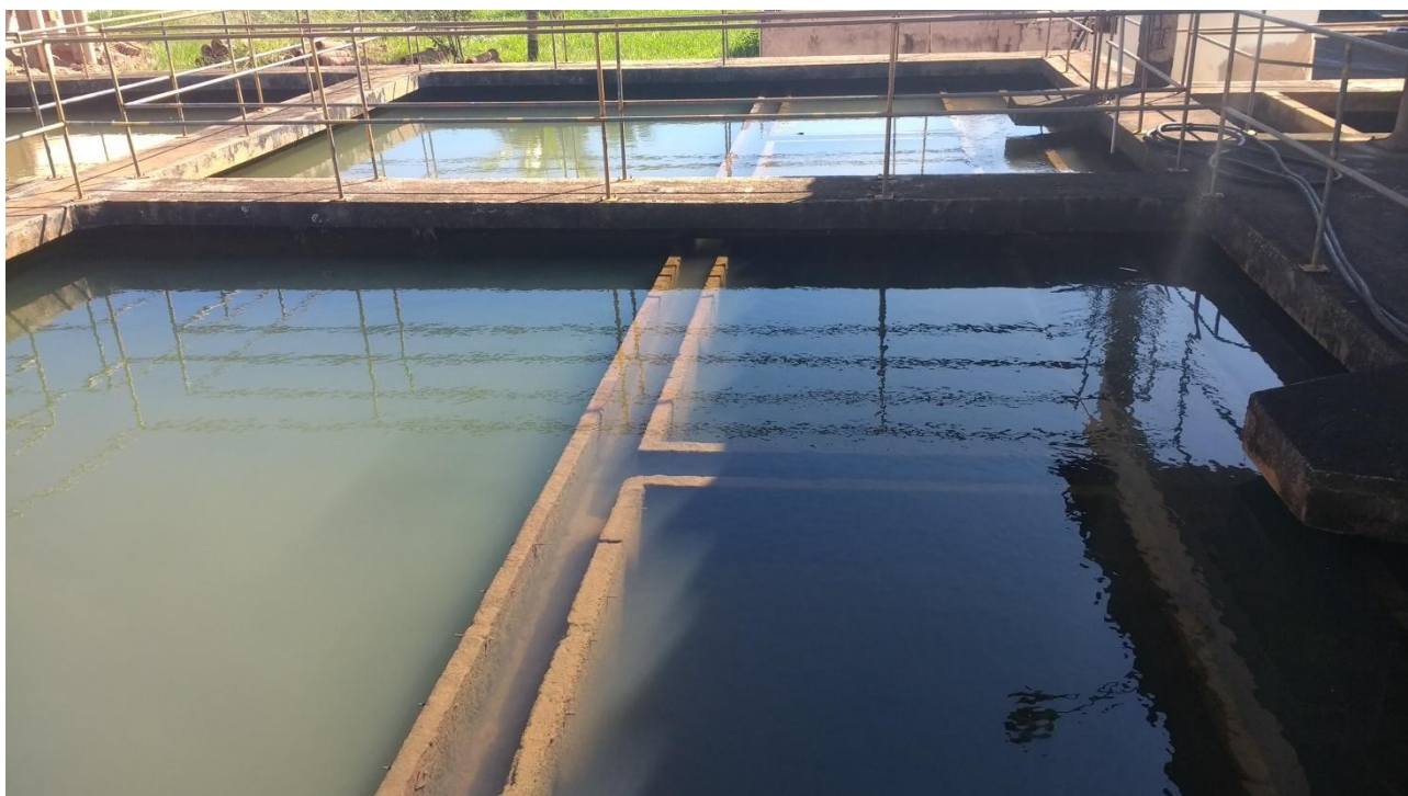
Figura 28 – Decantadores em operação afogados
