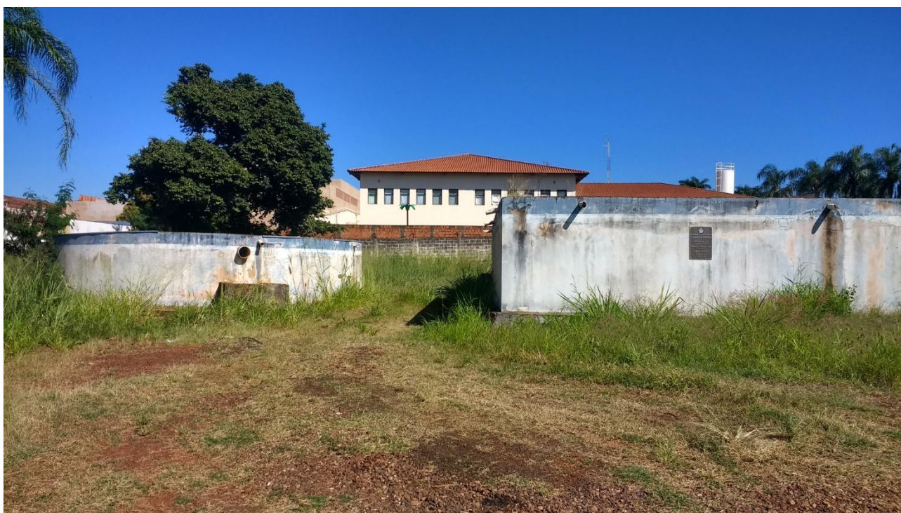
Figura 40 – Reservatórios CR ETA
