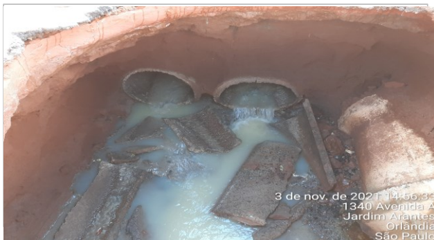
FOTO 3 - OBRA 1. Ruptura da Galeria de 600 mm . Tubulação corroída por baixo, ruptura superior pela diminuição da resistência. Lina de drenagem de tubulação
