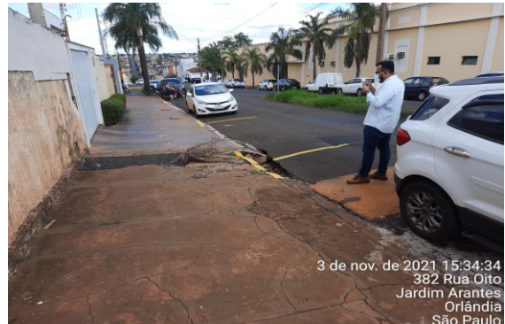
FOTO 14 - OBRA 3. Ruptura da Galeria de 600 mm e erosão causada pela enxurrada - Rua 08 Esquina
