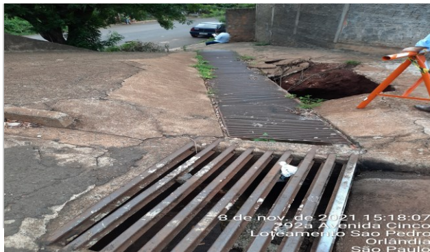
FOTO 7 - OBRA 2. Ruptura da Caixa de ligação do Ramal com o Extravasor - Rua 13 Esquina com avenida "5".
