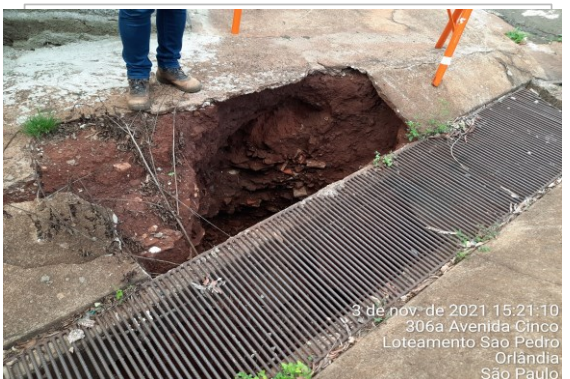
FOTO 12 - OBRA 2. Ruptura da Caixa de ligação do Ramal com o Extravasor - Rua 13 Esquina com avenida "5".
