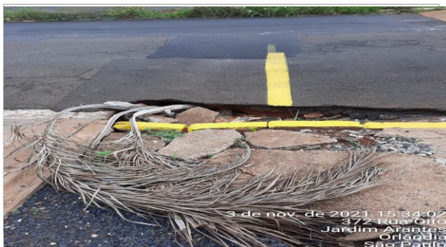
FOTO 15 - OBRA 3. Ruptura da Galeria de 600 mm e erosão causada pela enxurrada - Rua 08 Esquina com avenida "5". Orlândia/SP.
