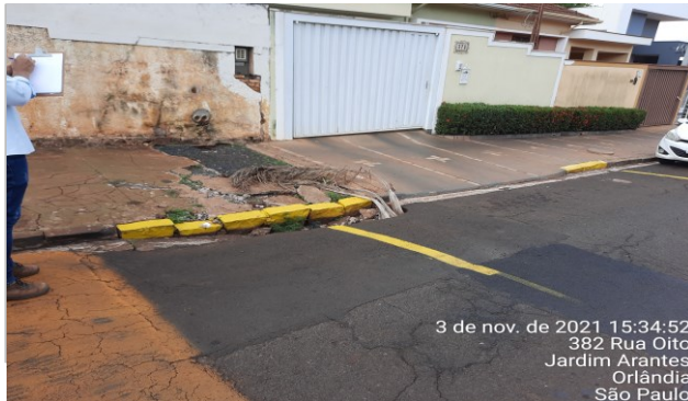
FOTO 13 - OBRA 3. Ruptura da Galeria de 600 mm e erosão causada pela enxurrada - Rua 08 Esquina com
