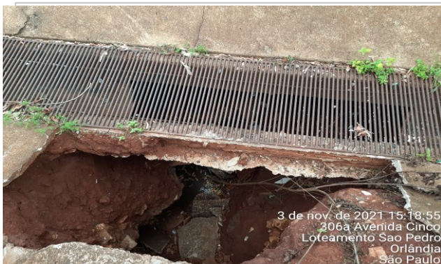
FOTO 11 - OBRA 2. Ruptura da Caixa de ligação do Ramal com o Extravasor - Rua 13 Esquina com avenida "5".
