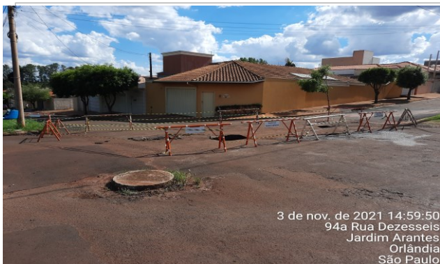
FOTO 5 - OBRA 1 - Ruptura da Galeria de 600 mm e erosão causada pela enxurrada - Rua 16 Esquina com
