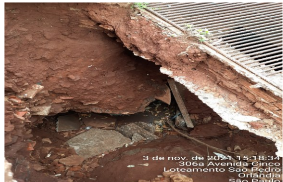
FOTO 8 - OBRA 2. Ruptura da Caixa de ligação do Ramal com o Extravasor - Rua 13 Esquina com avenida "5".
