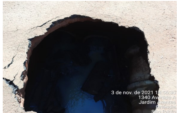
FOTO2 - OBRA 1. Ruptura da Galeria de 600 mm e erosão causada pela enxurrada - Rua 16 Esquina
