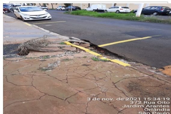
FOTO 18 - OBRA 3. Ruptura da Galeria de 600 mm e erosão causada pela enxurrada - Rua 08 Esquina com
