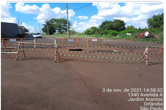
FOTO 6 - OBRA 01 - Ruptura da Galeria de 600 mm e erosão causada pela enxurrada - Rua 16 Esquina com
