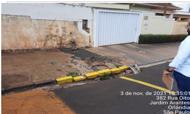
FOTO 17 - OBRA 3. Ruptura da Galeria de 600 mm e erosão causada pela enxurrada - Rua 08 Esquina com
