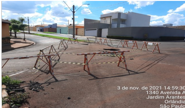
FOTO 1 - OBRA 1. Ruptura da Galeria de 600 mm e erosão causada pela enxurrada - Rua 16 Esquina com avenida "A".
