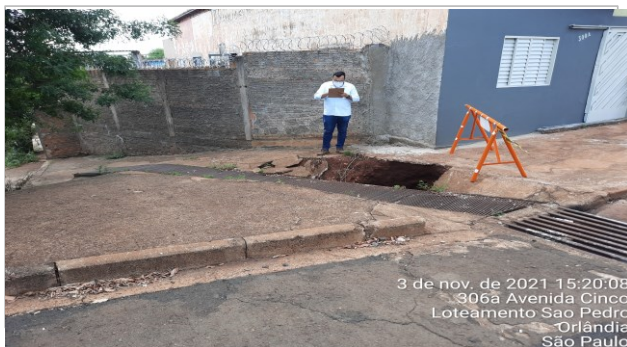
FOTO 9 - OBRA 2. Ruptura da Caixa de ligação do Ramal com o Extravasor - Rua 13 Esquina com avenida "5". Orlândia/SP.
