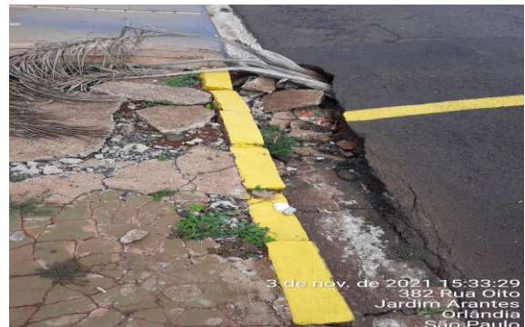
FOTO 16 - OBRA 3. Ruptura da Galeria de 600 mm e erosão causada pela enxurrada - Rua 08 Esquina com avenida "5". Orlândia/SP.
