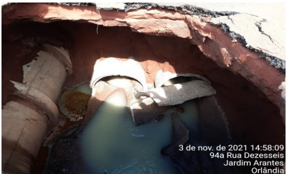
FOTO 4 - OBRA 1. Ruptura da Galeria de 600 mm. Tubulação corroída por baixo, ruptura superior pela diminuição da resistência. Lina de drenagem de
