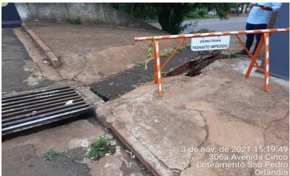
FOTO 10 - OBRA 2. Ruptura da Caixa de ligação do Ramal com o Extravasor - Rua 13 Esquina com avenida "5". Orlândia/SP.
