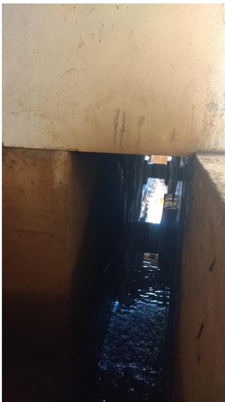
Figura 26 – Vazamento de grande proporção – ETA Orlândia
