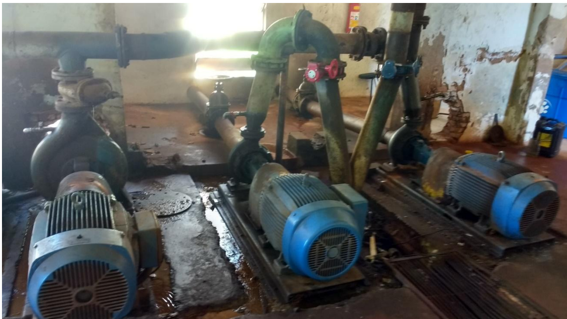
Figura 42 – Conjuntos Motobomba EEAT1
