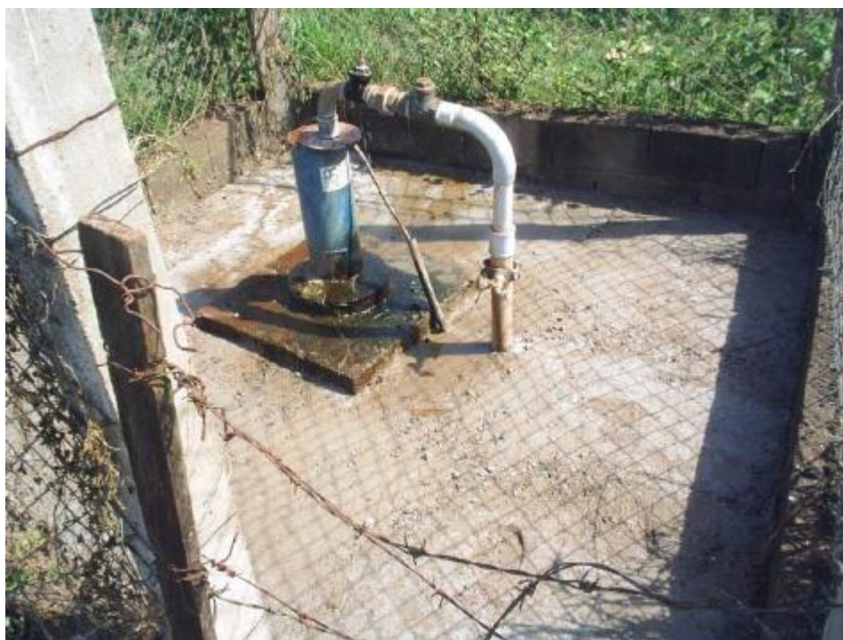
Figura 38 – Poço P10 – Capão do Meio
