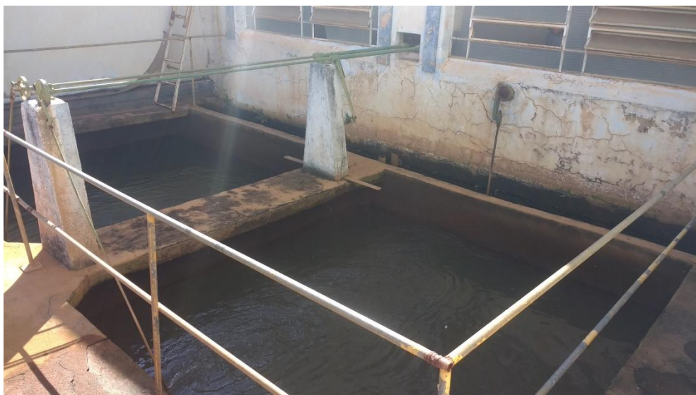
Figura 29 – Vista Geral de dois módulos de filtração
