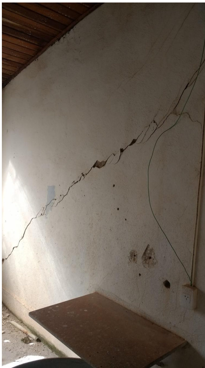
Figura 30 – Rachadura em parede do edifício da ETA
