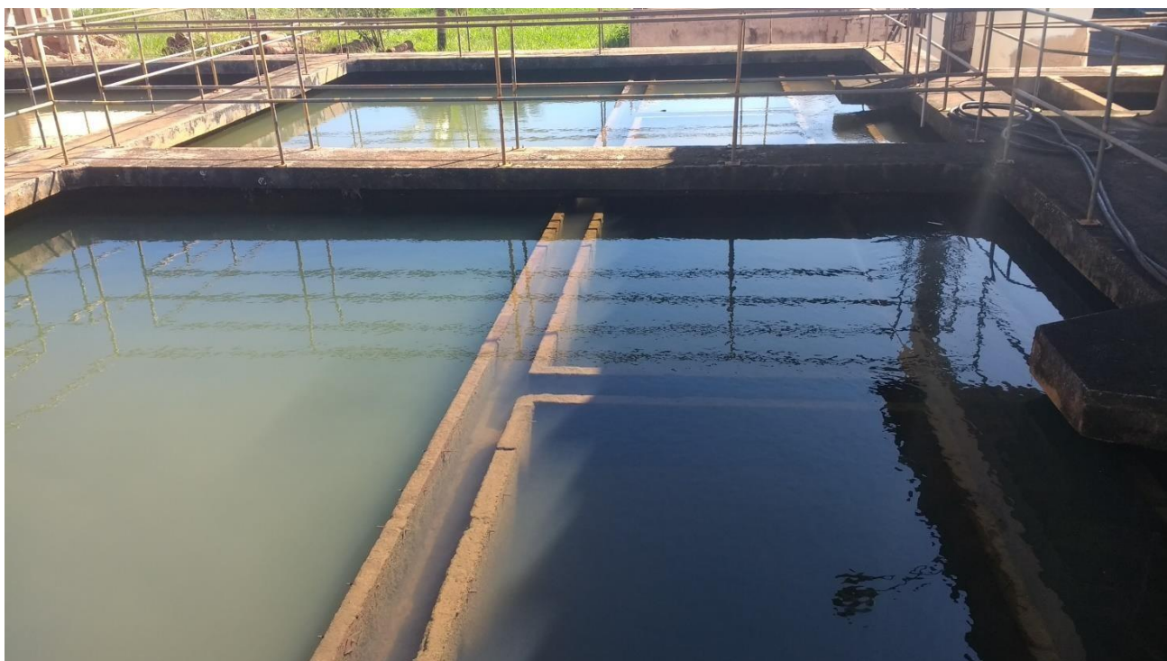
Figura 28 – Decantadores em operação afogados
