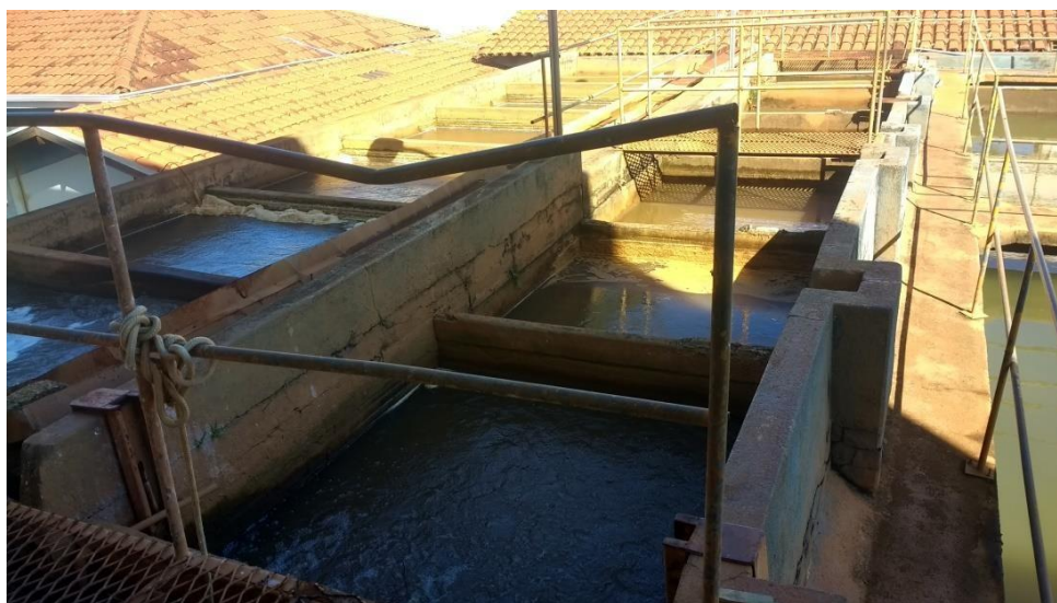
Figura 25 – Flocladores da ETA de Orlandia
