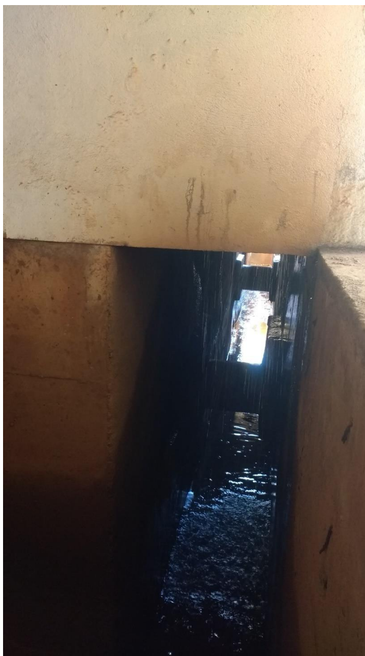
Figura 26 – Vazamento de grande proporção – ETA Orândia
