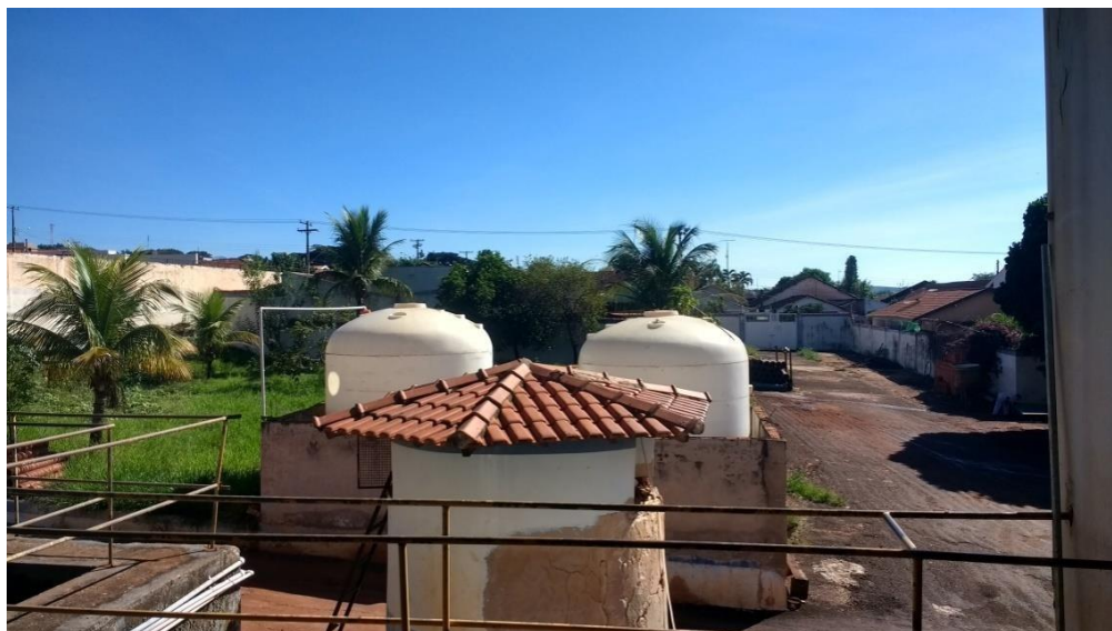
Figura 19 – Tanques de armazenamento de sulfato de alumínio
