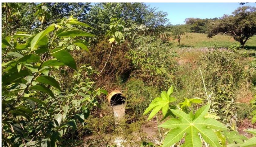
Figura 55 – Travessia Rompida no Ribeirão dos Agudos
