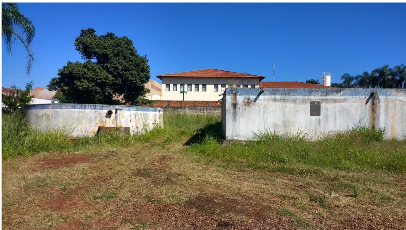
Figura 40 – Reservatórios CR ETA
