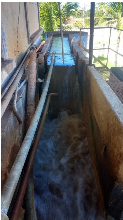
Figura 24 – Dispositivo de mistura rápida - ETA
