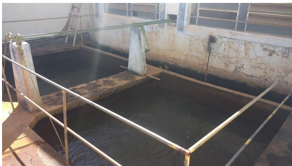
Figura 29 – Vista Geral de dois módulos de filtração
