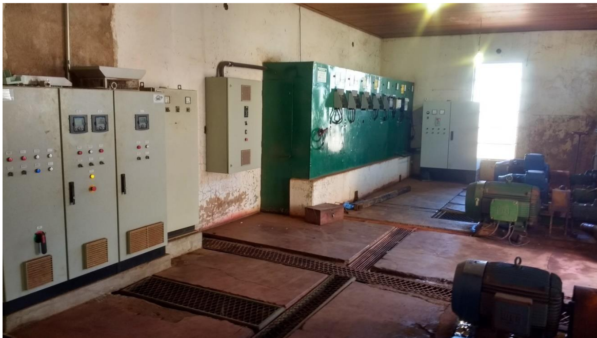
Figura 44 – EEAB e EEAT1
