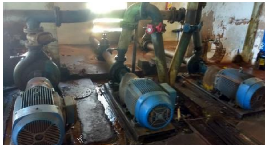
Conjunto motorbomba EEAT1
