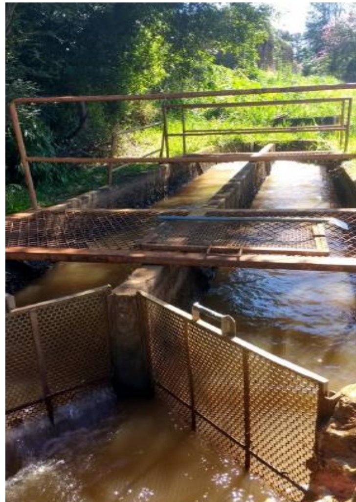
Gradeamento e Canal Desarenador
