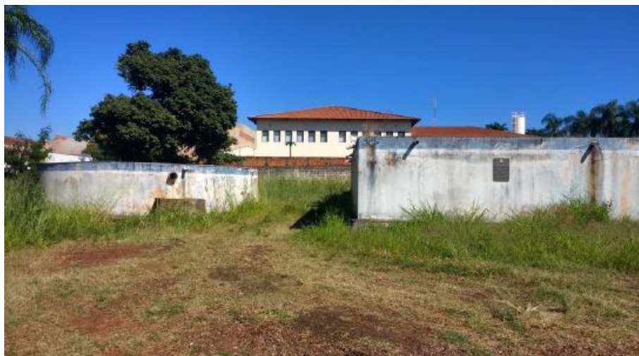
Reservatório CR ETA
