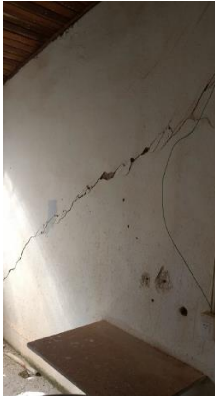
Rachaduras em paredes do edifício da ETA
