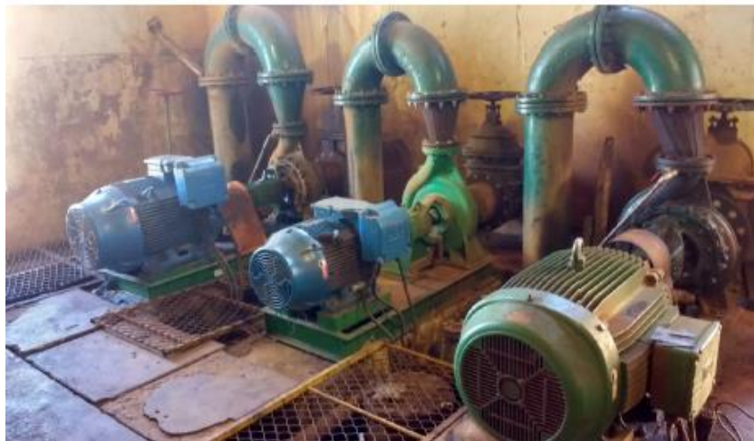
Conjunto motorbomba EEAB
