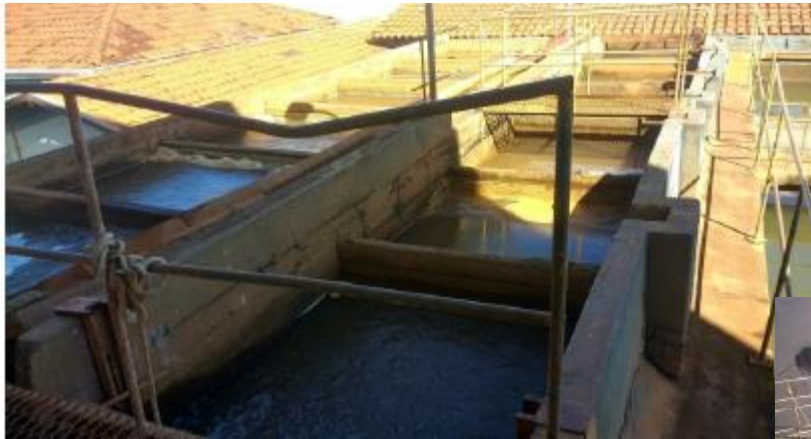
Floculadores da ETA
