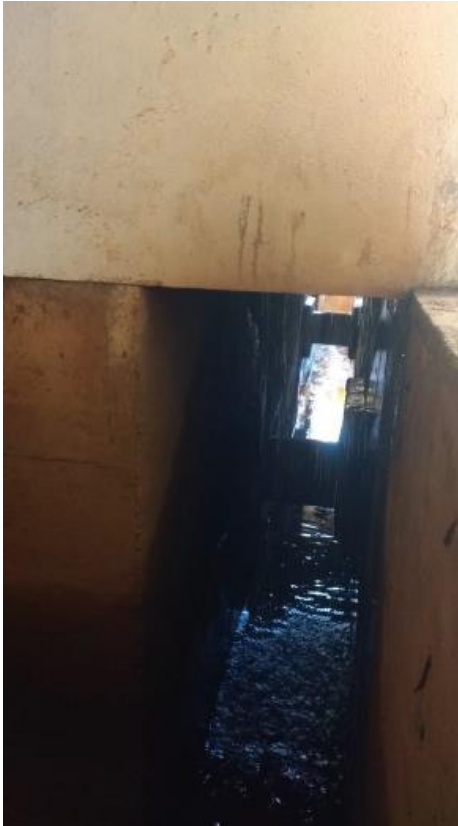
Vazamento na ETA
