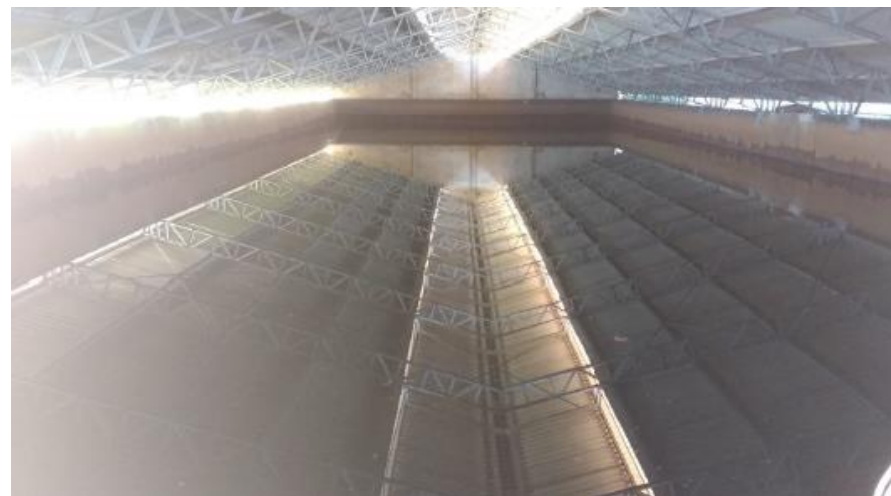
Reservatório CR 05 ETA
