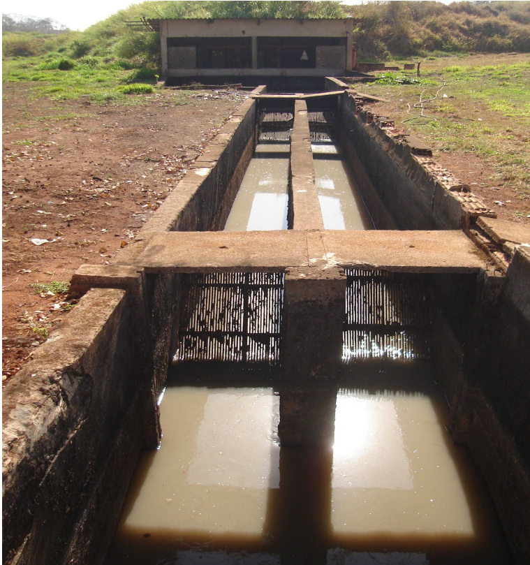
Ilustração 5.39 - Vista da estrutura de tratamento preliminar composta por grades médias e caixas de areia. Ao fundo, vista da estação elevatória.
