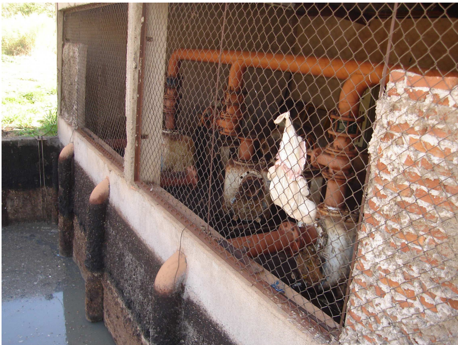
Ilustração 5.40 - Vista parcial do poço de sucção e dos conjuntos motobomba da EE de esgoto pré-tratado
