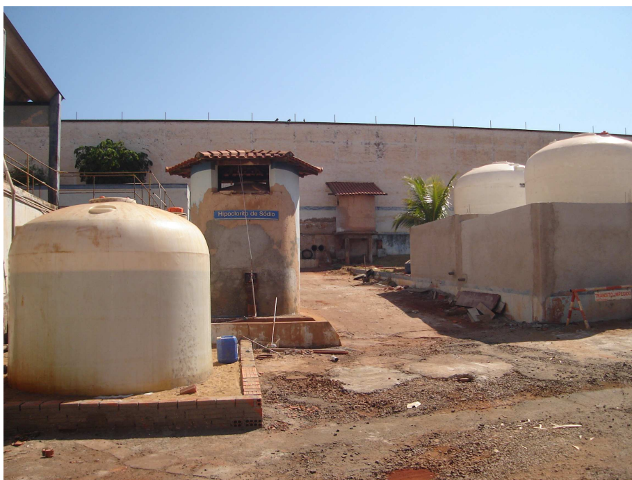
Ilustração 5.19 - Vista dos tanques estacionários. Em primeiro plano, tanque provisório para o armazenamento de sulfato de alumínio. Em segundo plano a esquerda, tanque de hipoclorito de sódio e, a direita, tanques definitivos para o sulfato de alumínio (em fase de implantação).
