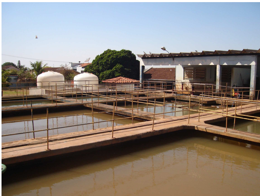
Ilustração 5.14 - Vista parcial dos decantadores
