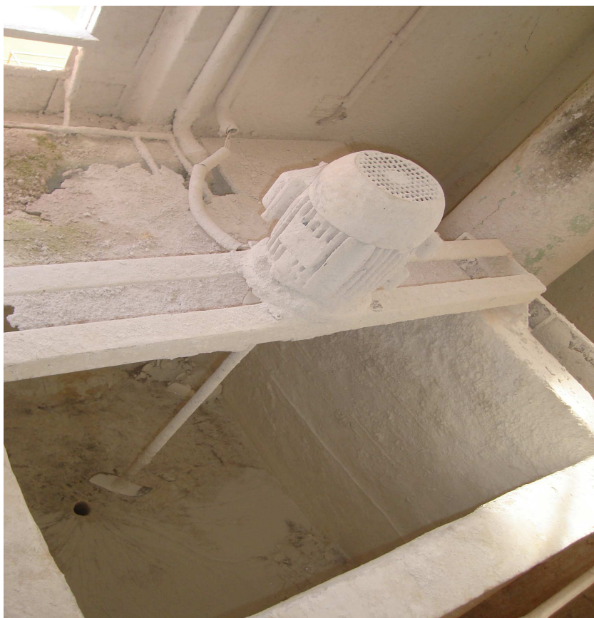
Ilustração 5.20 - Tanque de preparo de suspensão de cal (segundo pavimento da Casa de Química)
