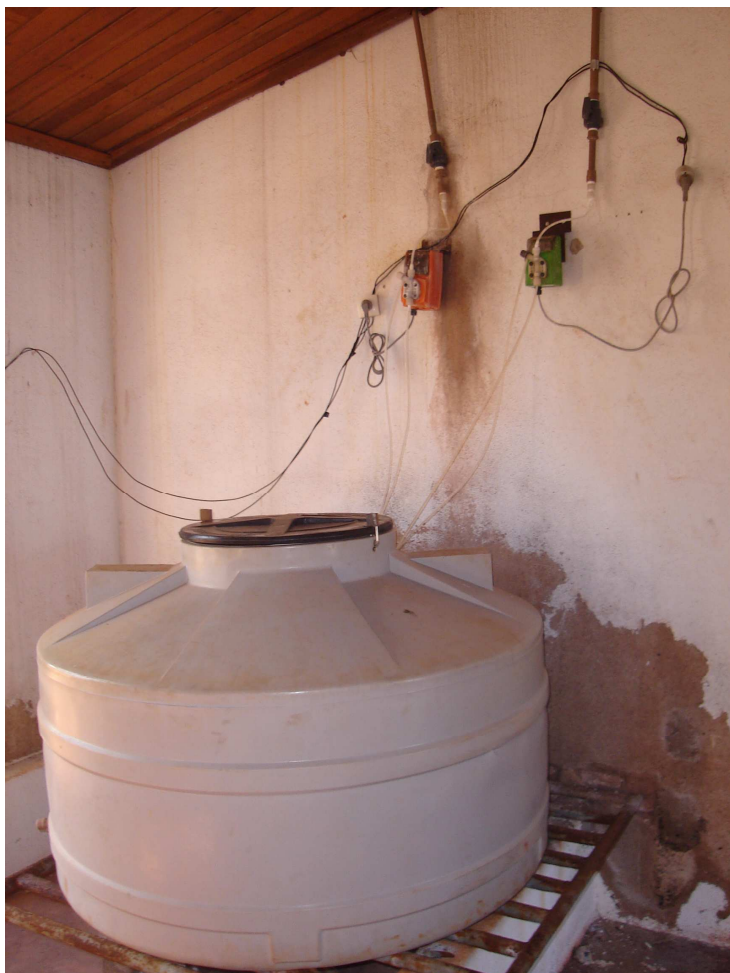
Ilustração 5.6 – Sistema de armazenamento e aplicação de hipoclorito de sódio para pré-oxidação da água bruta e desinfecção da água captada pelos poços P1 e P5
