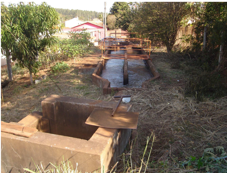
Ilustração 5.3 - Caixas de areia para o pré-tratamento da água bruta captada no córrego do Palmito
