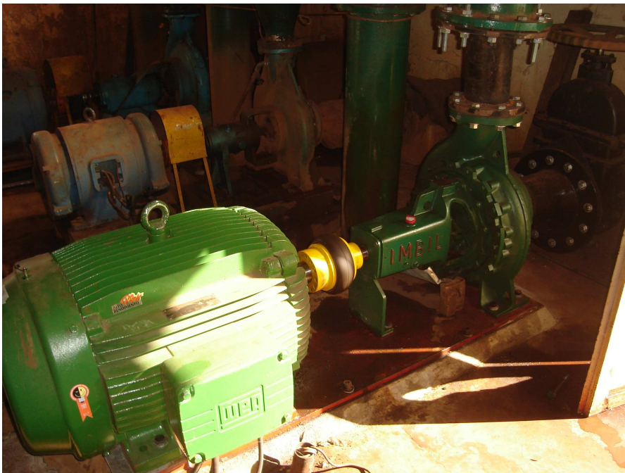
Ilustração 5.5 - Conjunto motobomba recentemente implantado na EE de água bruta que alimenta a ETA
