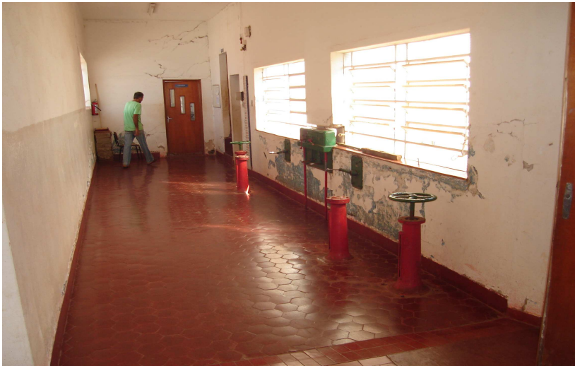
Ilustração 5.17 - Corredor de comando dos filtros
