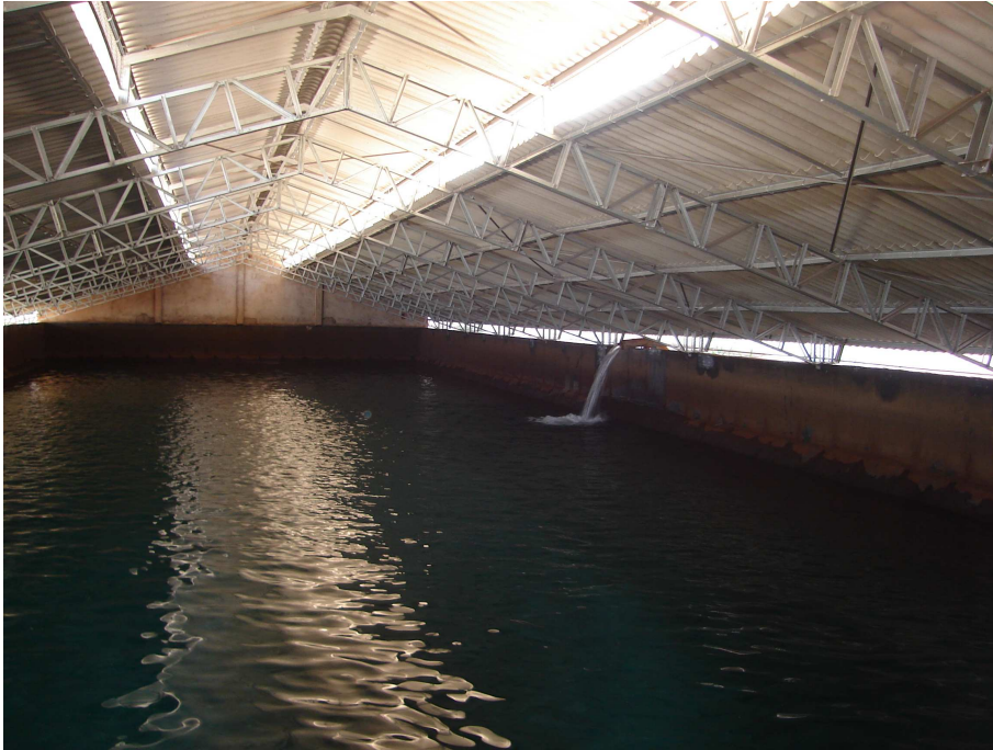
Ilustração 5.31 - Vista interna do maior reservatório do CR ETA. Destaque para sua cobertura metálica do tipo telhado de duas águas.
