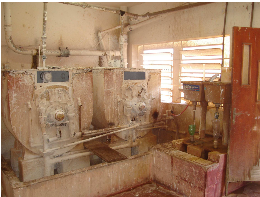
Ilustração 5.22 - Dosadores de canecas para a cal hidratada (a esquerda), dosadores de nível constante para o sulfato de alumínio (a direita), localizados no primeiro pavimento da Casa de Química.
