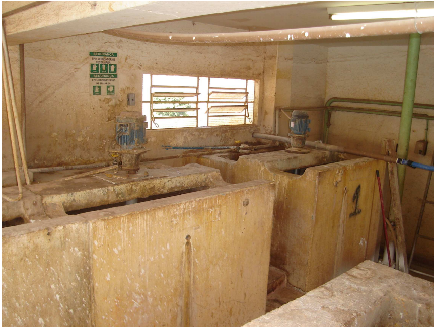
Ilustração 5.21 - Tanques de diluição da solução concentrada de sulfato de alumínio (segundo pavimento da Casa de Química)
