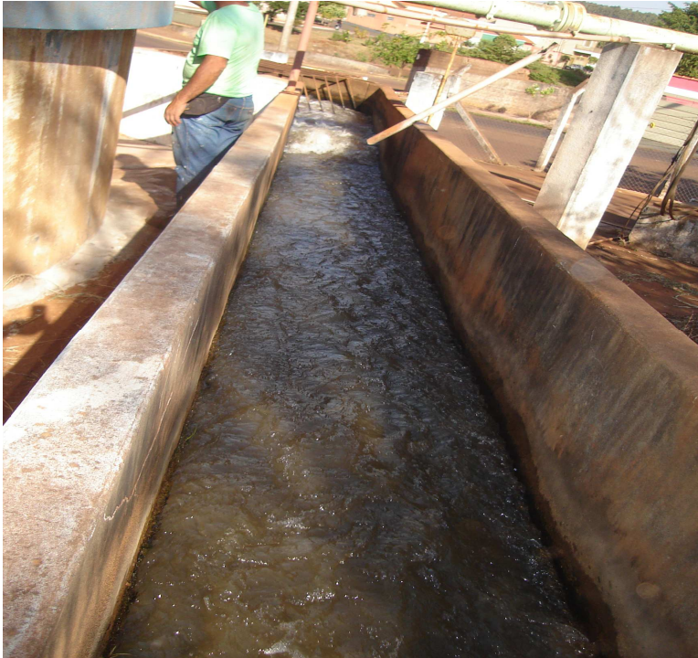
Ilustração 5.4 - Canal de água bruta a jusante das caixas de areia
