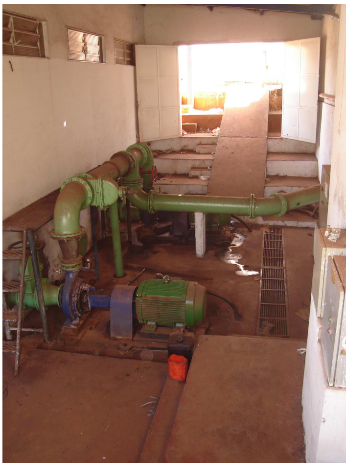
Ilustração 5.33 - Vista geral da EEAT do CR ETA
