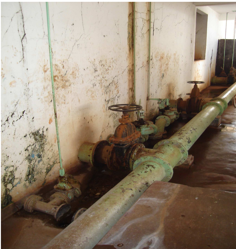
Ilustração 5.18 - Galeria dos barriletes de água filtrada e de lavagem dos filtros
