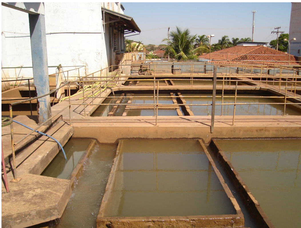
Ilustração 5.15 - Vista da porção de jusante dos decantadores com destaque para as calhas de coleta de água decantada
