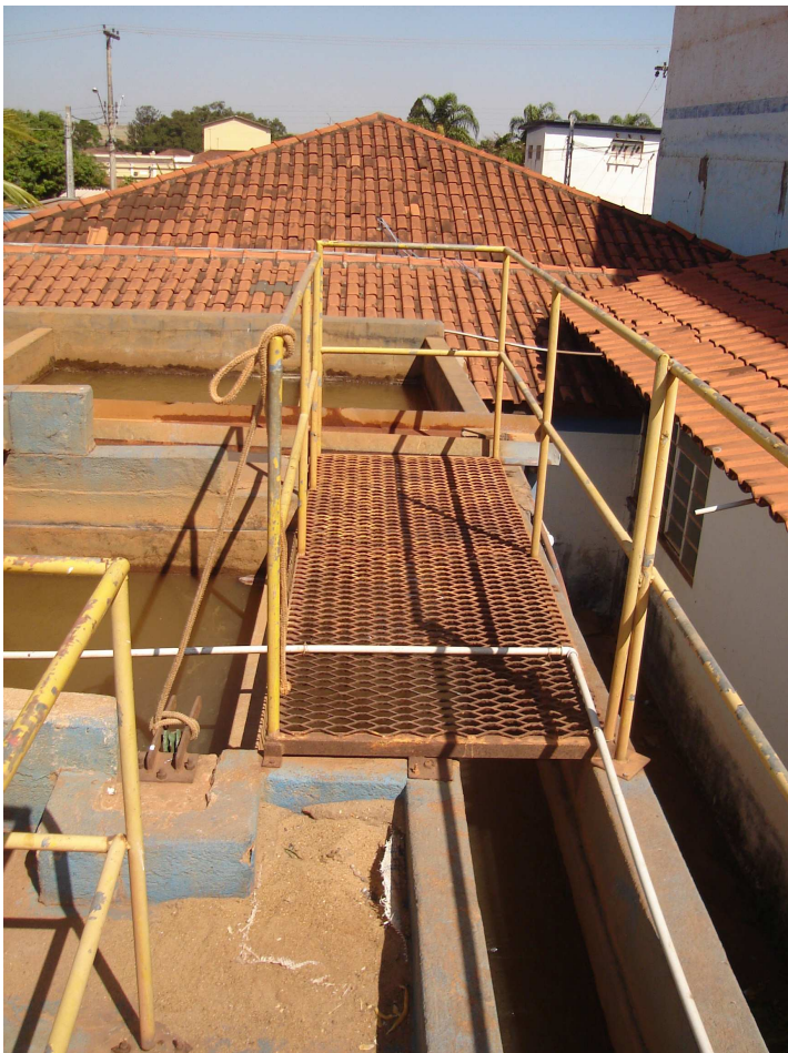
Ilustração 5.13 - Vista dos floculadores a partir de sua porção de jusante (Em primeiro plano, vista do trecho inicial do canal de água floculada)
